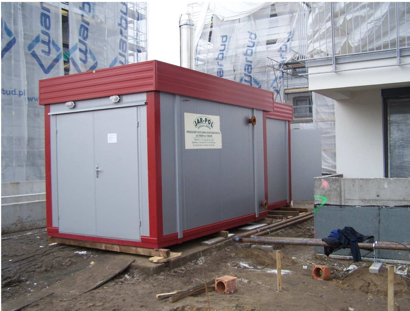
Rys. 6 Kotłownia kontenerowa 350 kW, Warszawa (WARBUD)
