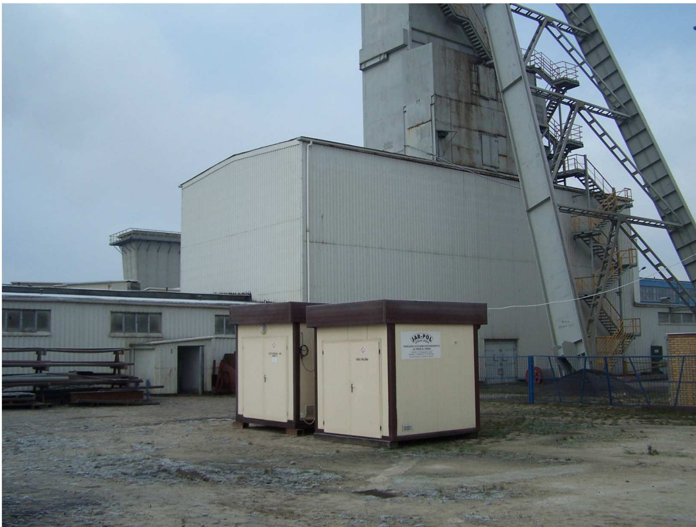
Rys. 5 Kotłownia kontenerowa 886 kW, Bogdanka
