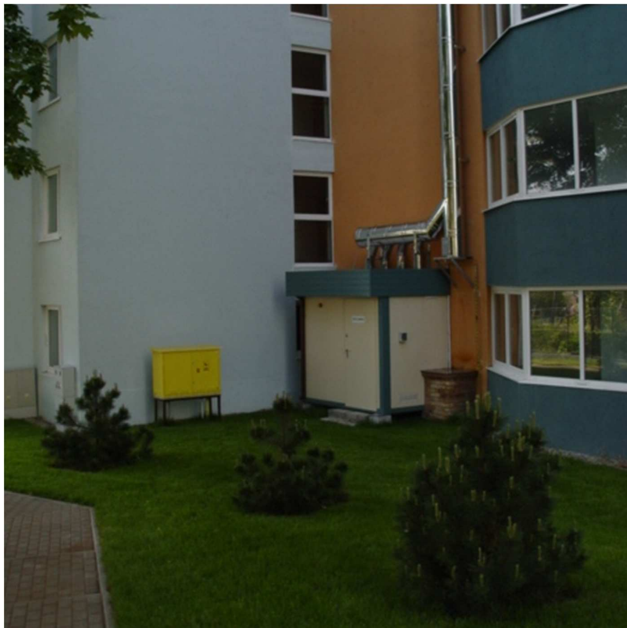
Rys. 4 Kotłownia kontenerowa o mocy 360kW, Międzyzdroje
