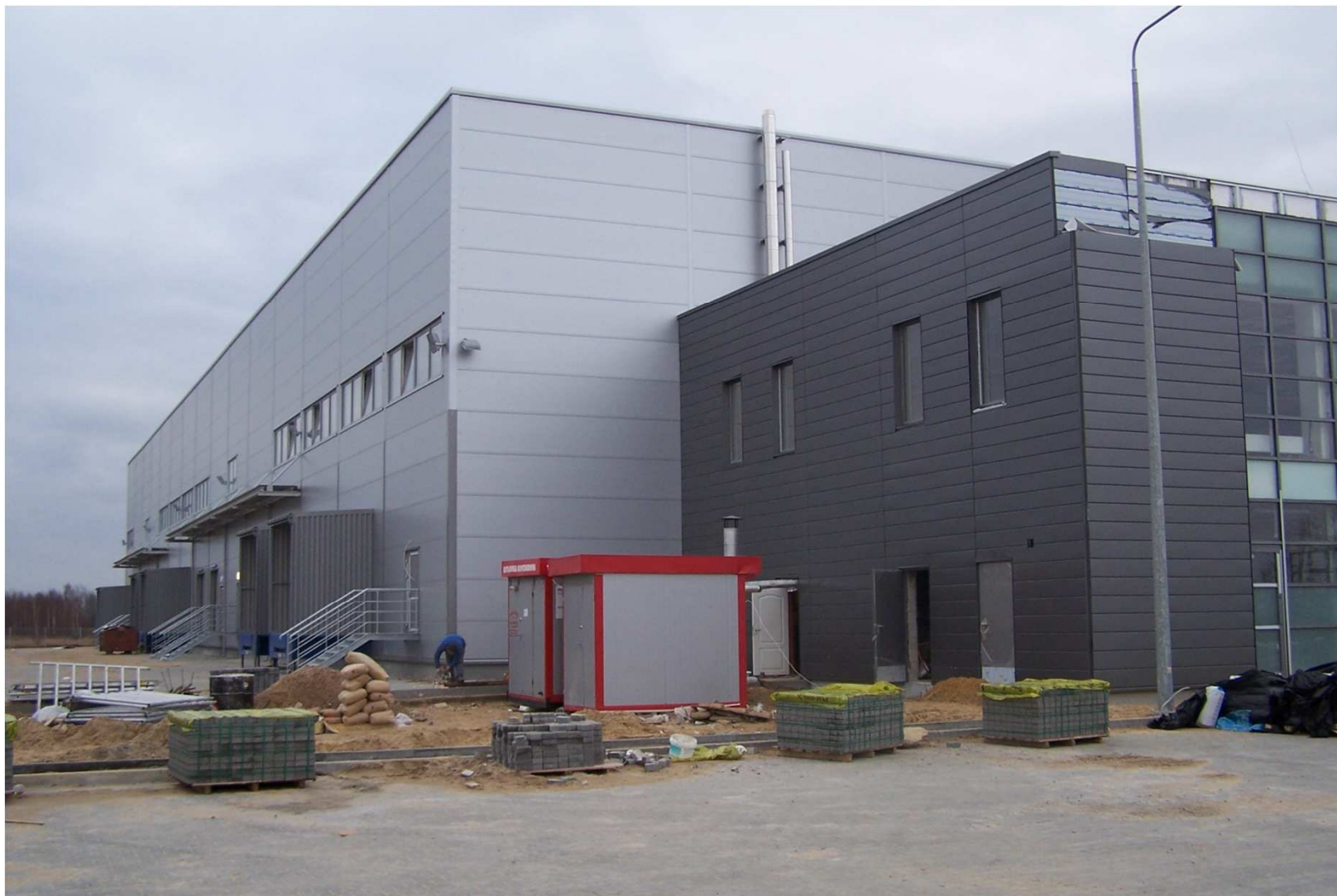
Rys. 3 Kotłownia kontenerowa 350kW, Lemcom Polska Radzymin k/Warszawy
