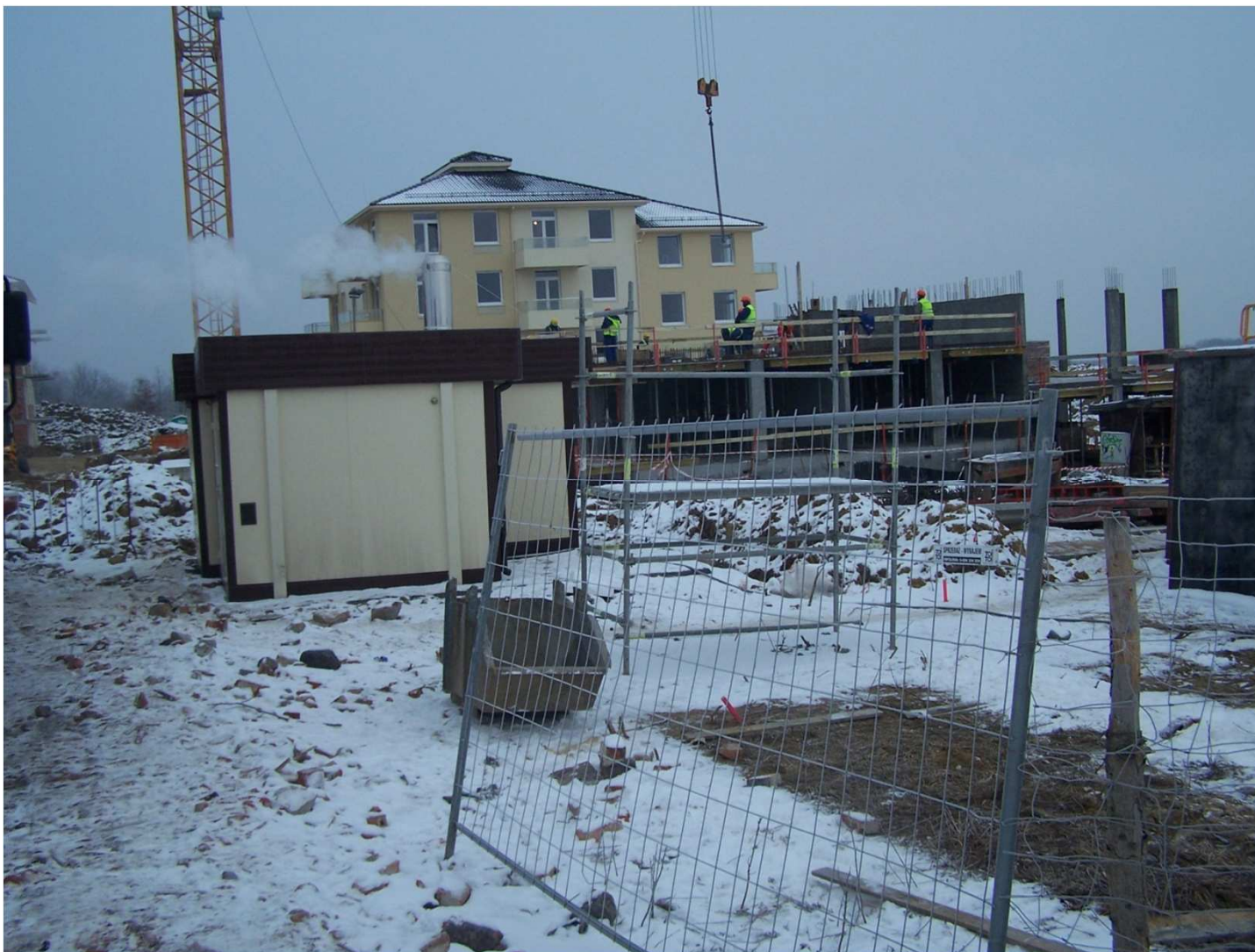
Rys. 7 Kotłownia kontenerowa 510 kW, Gdańsk, Osiedle Gardenia
